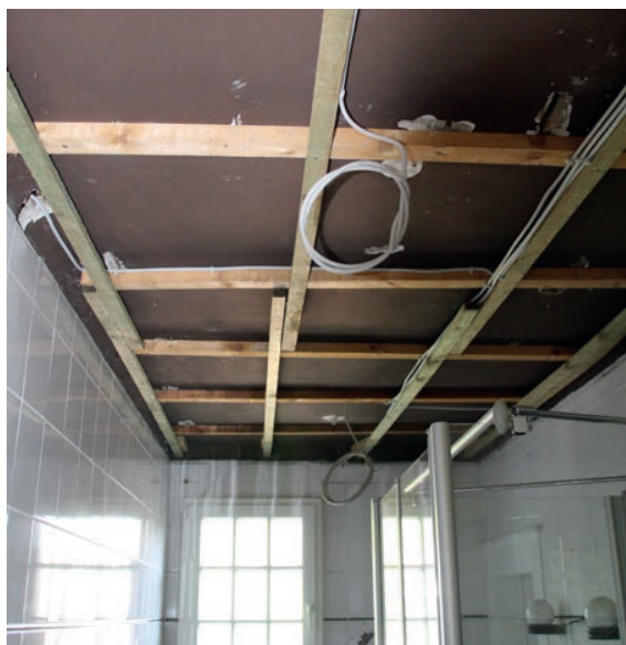
Decke Bad vorher
